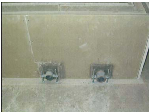
| 防火区画壁貫通部（配管廻り隙間の防火措置）
