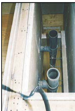
| 耐火構造壁の外での配管
